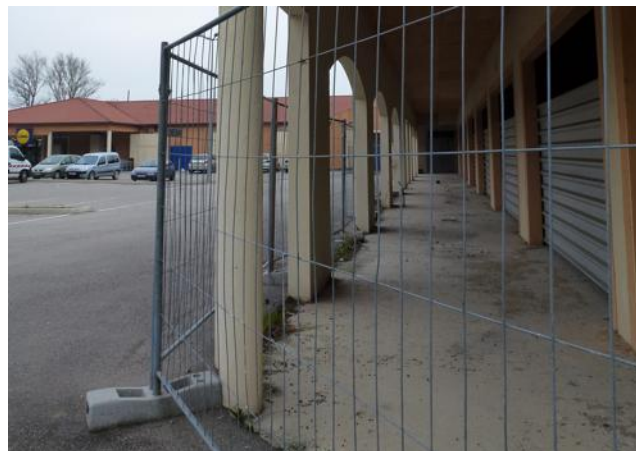
■ A l'époque des malfaçons. Photo S.M
